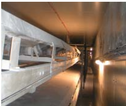
Grafik 4: Installation des RedGuard® Sensorkabels, zentral in der Mitte einer Förderbandanlage.
