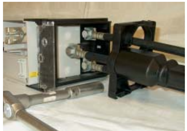
Bild 9: SASIL 3 Sicht auf Klemmen mit Montagerahmen und einer Tülle, 3 Kabel angeschlossen
