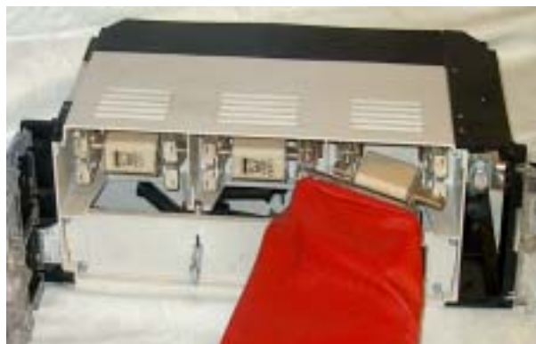
Bild 14: Wechseln der Sicherungen
